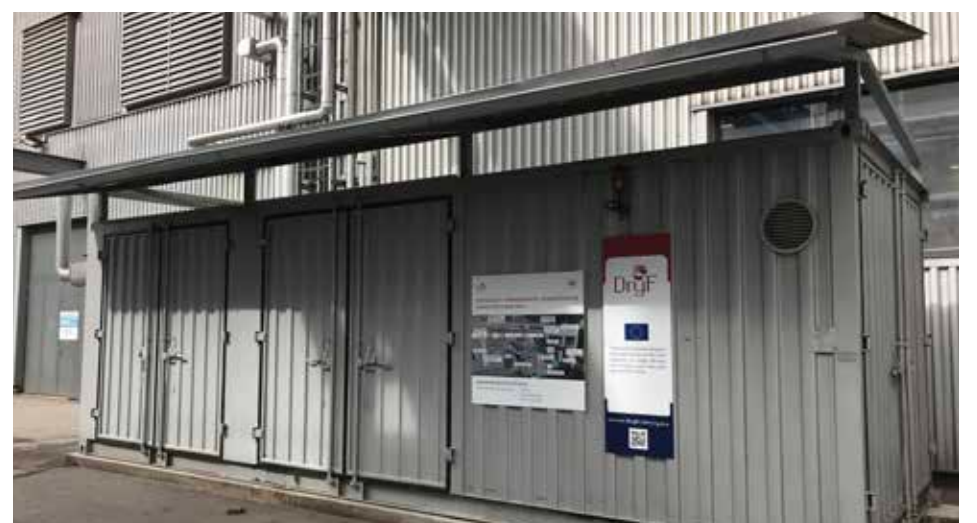
Die Hochtemperatur-Wärmepumpe der AGRANA Stärke GmbH in Pischelsdorf.
